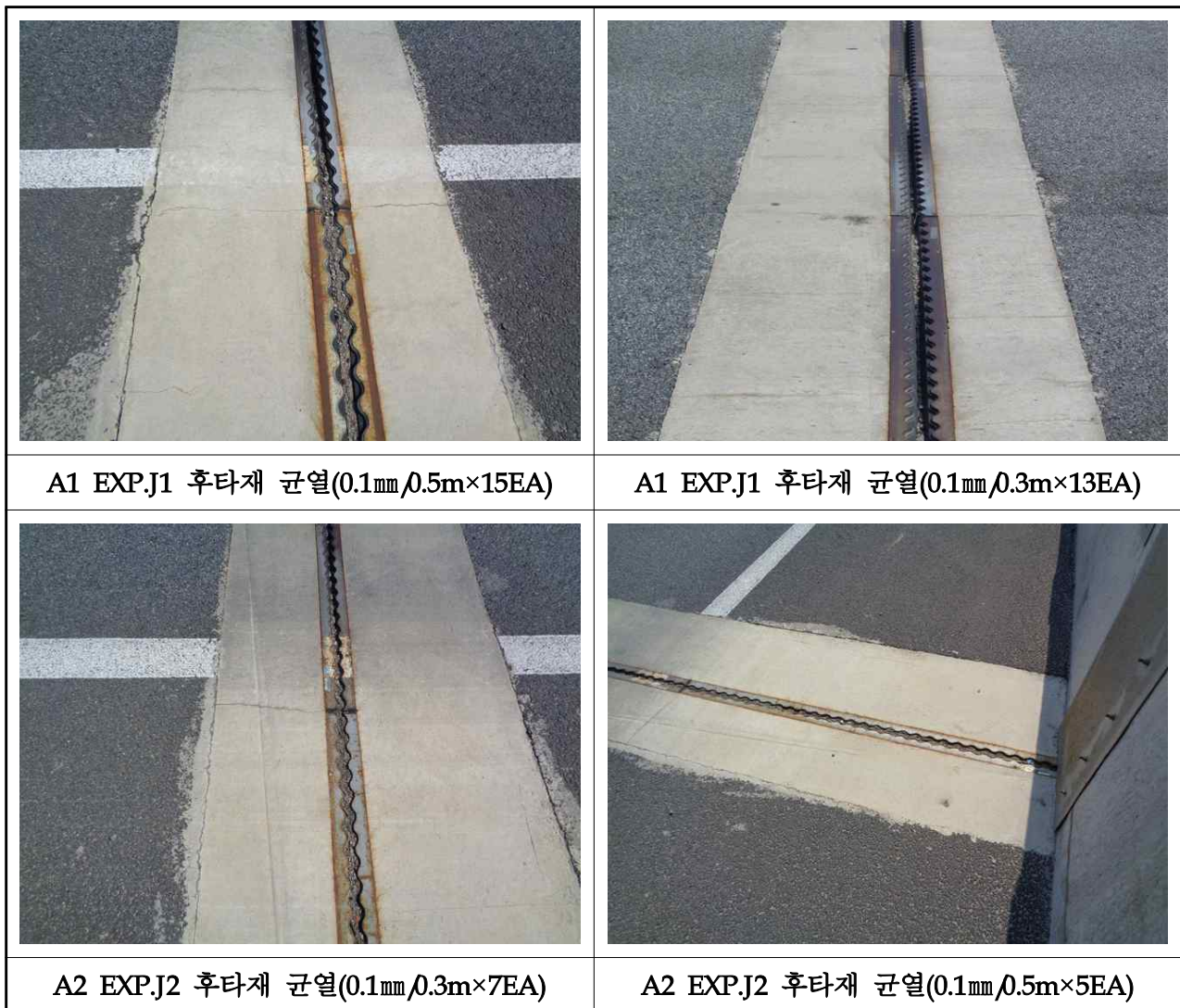
【사진 3.17】 신축이음장치 손상현황
