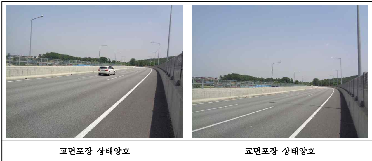
【사진 3.20】 교면포장 손상현황
